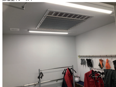
採暖室(冷凍倉庫)
